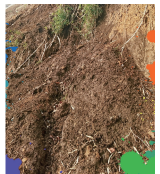
写真は心配されている崖です。
